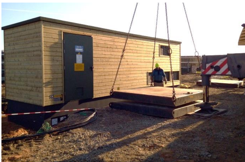
Photo 4 : Exemple d'un poste de livraison (photo prise en phase chantier Source : IEL)
