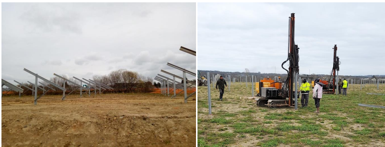
Photo 5 et 6 : Mise en place des pieux battus - photos de la construction de la Ferme Solaire Marc Energies, une réalisation IEL
