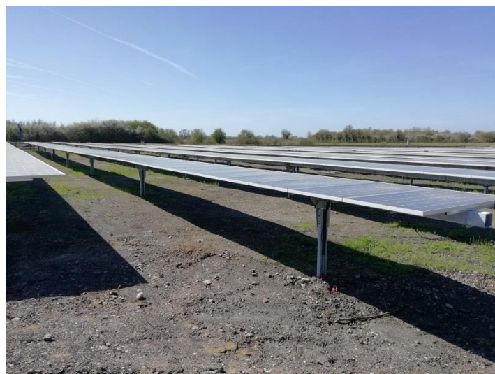
Photo 2 : Suiveurs à rotation mono-axiale (Site SNCF de Surdon – Château d'Almenêches, une réalisation IEL)
