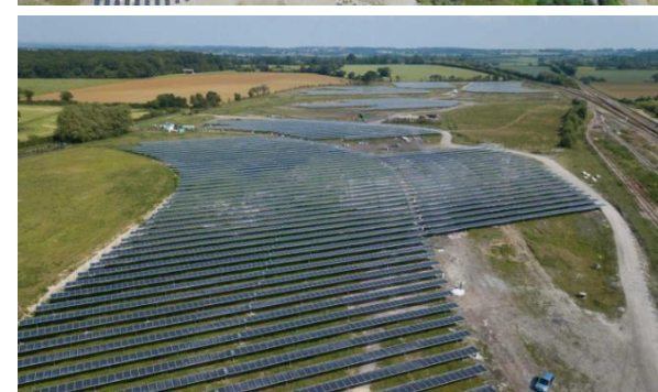
Site SNCF de Surdon – Château d'Almenêches (61) Centrale solaire photovoltaïque de 6,3 MWc Mise en service : 2018
